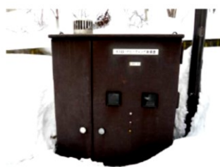
ロードヒーティングの装置
