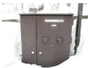
ロードヒーティングの装置
