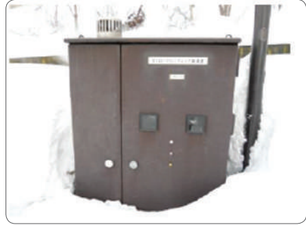
로드 히팅(Heating) 장치
